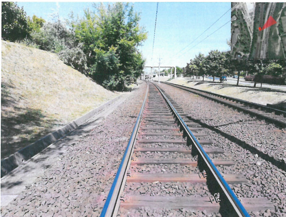
Fot.1. Stan istniejący – szlak (przed Przystankiem Słowiańska) – odwodnienie do rowów betonowych.
